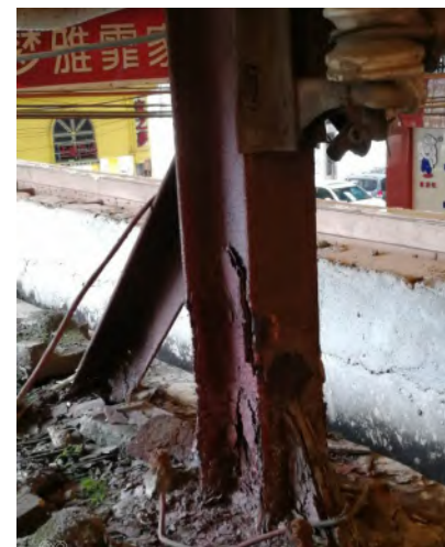
柱脚严重锈蚀
