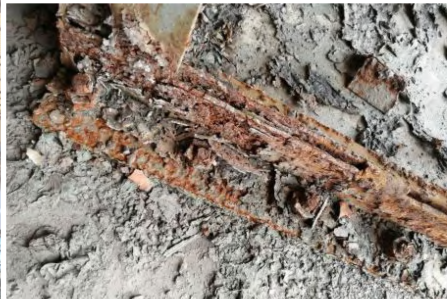
钢构件严重锈蚀
