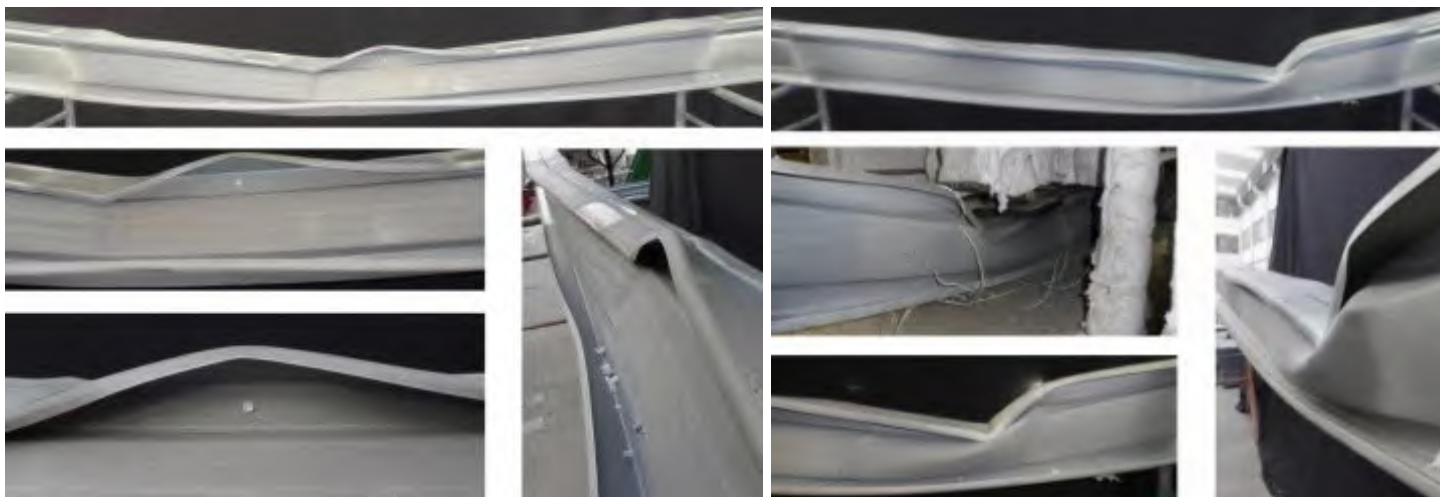
钢梁明显变形
