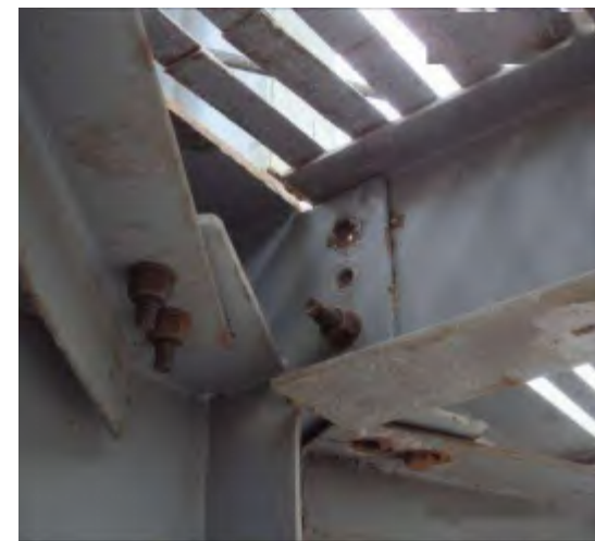
节点螺栓缺失
